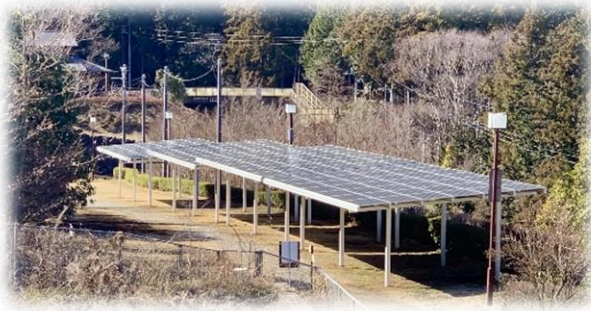
太陽光発電設備
